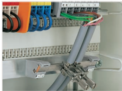
2 yalıtımlı taşıyıcı (790-100) üzerinde ortak potansiyelli ekranlama modülleri
